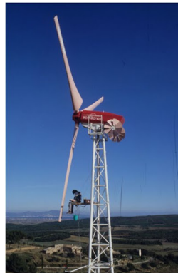
Aerogenerador instal·lat a Vilopriu. Font: Eoliccat
